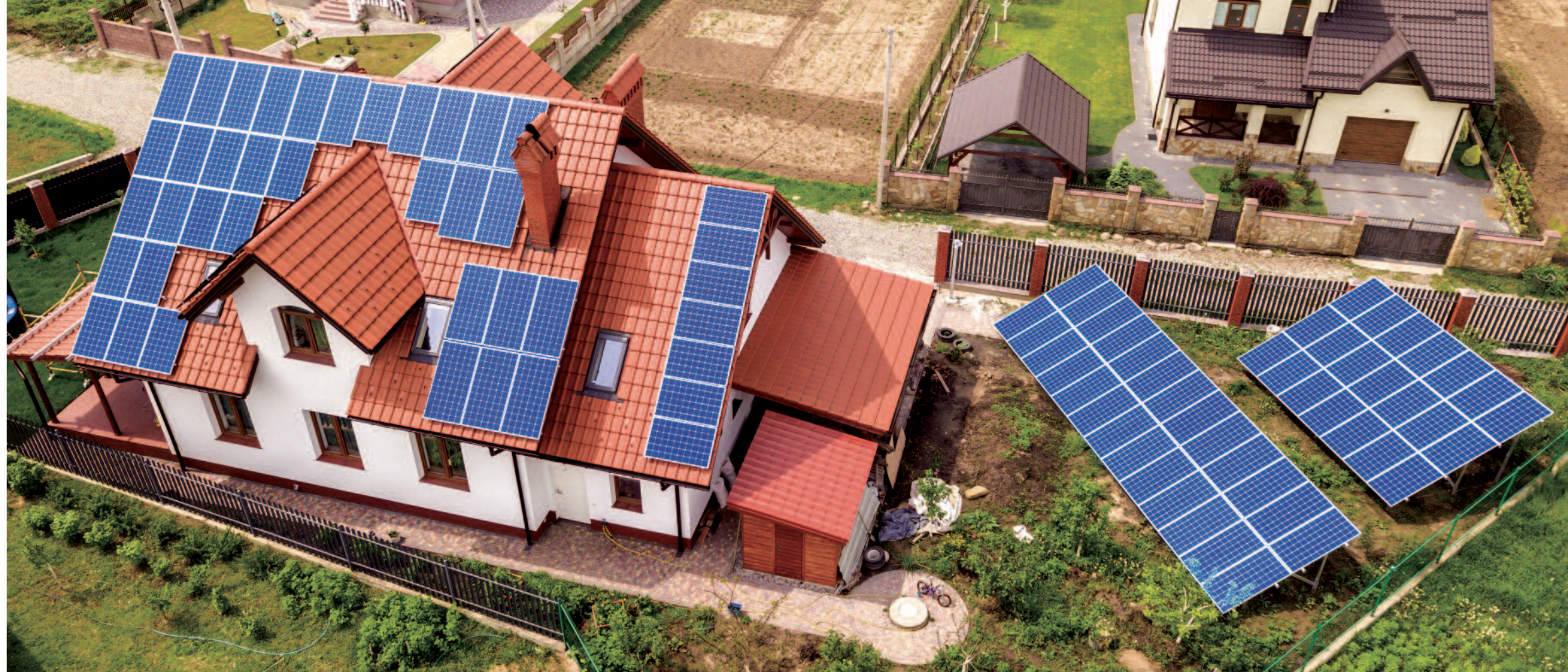
Panele fotowoltaiczne często instalowane są na zadaszeniu, gdzie liczy się zminimalizowanie ciężaru.
